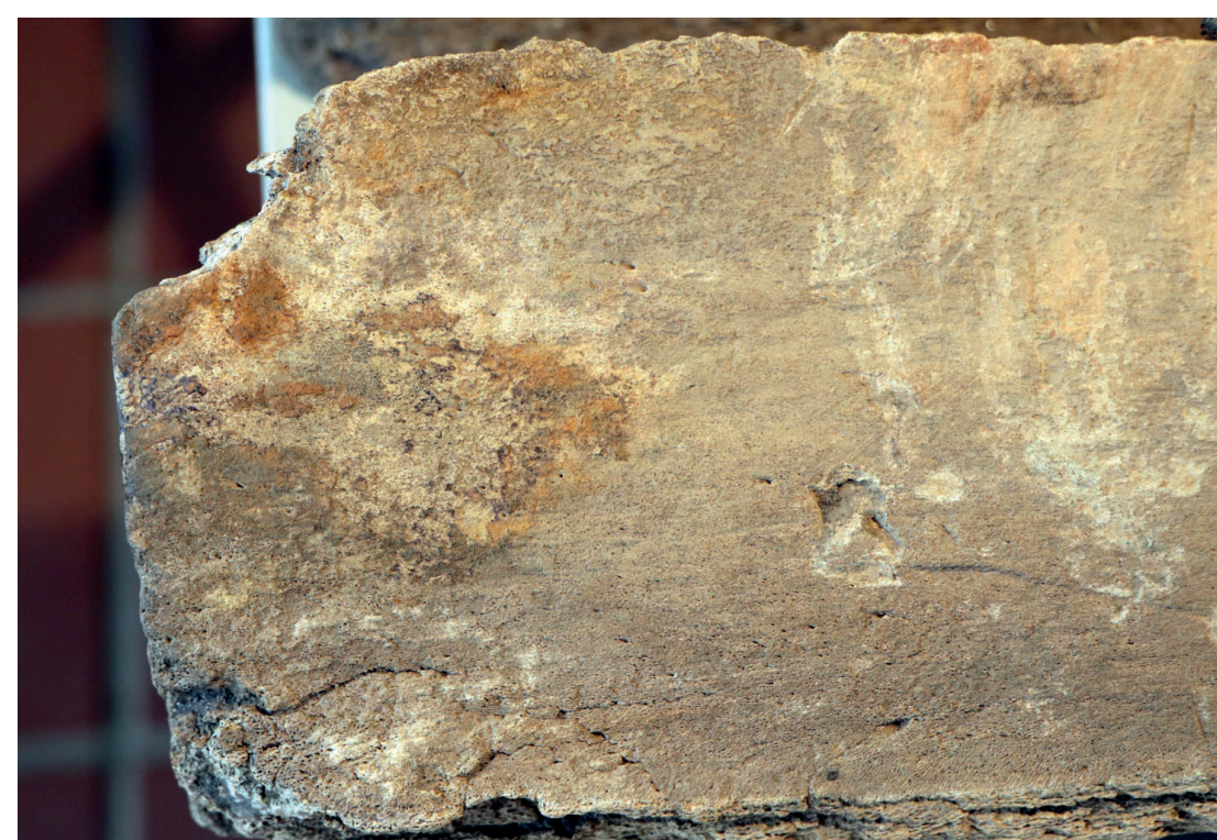
Abb. 8: Rostspuren einer eisernen Abdeckung an der Oberkante eines Pfostens. Foto Vitali Friesen 29. 3. 2023
