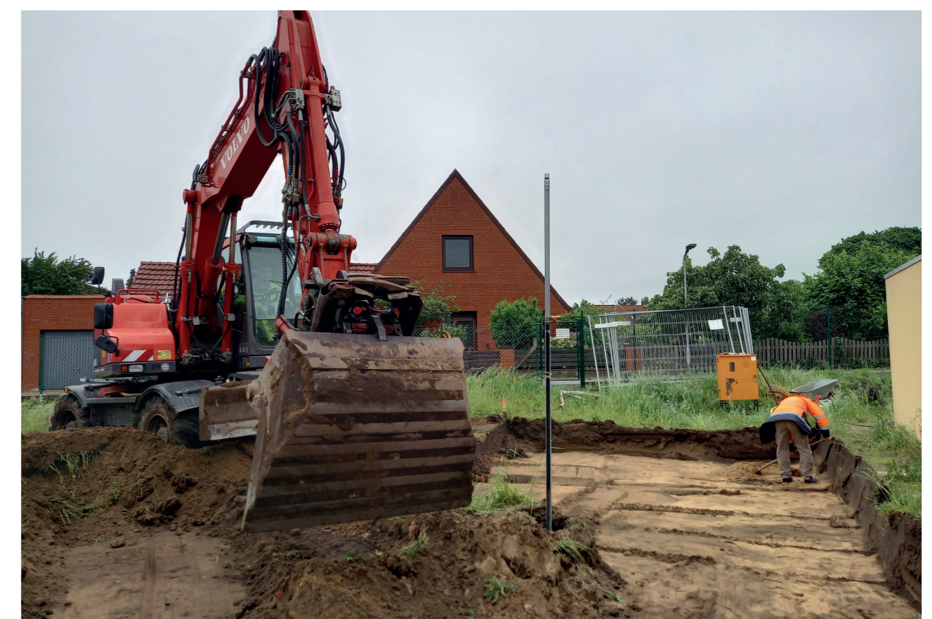
Während eine Fläche abgezogen wird, steht ein:e Archäolog:in dabei um aufzupassen, dass nichts Wichtiges weggebagert wird
